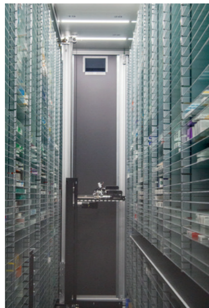
Modernste Logistik, versteckt und leise arbeitend
